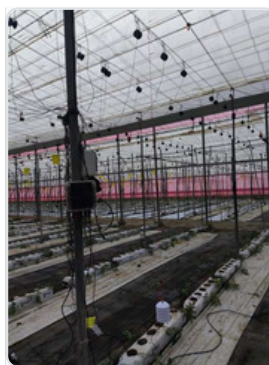
Sensor de radiación instalado en altura
