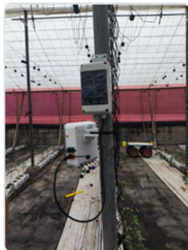
Caja de alimentación 12 V instalada junto al datalogger
